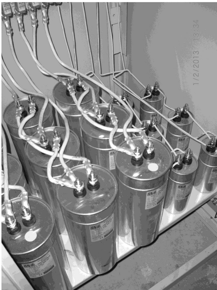
Рис. 16.5. Фото ёмкостей СФ на ВНС «Западная» Ростовского водоканала
