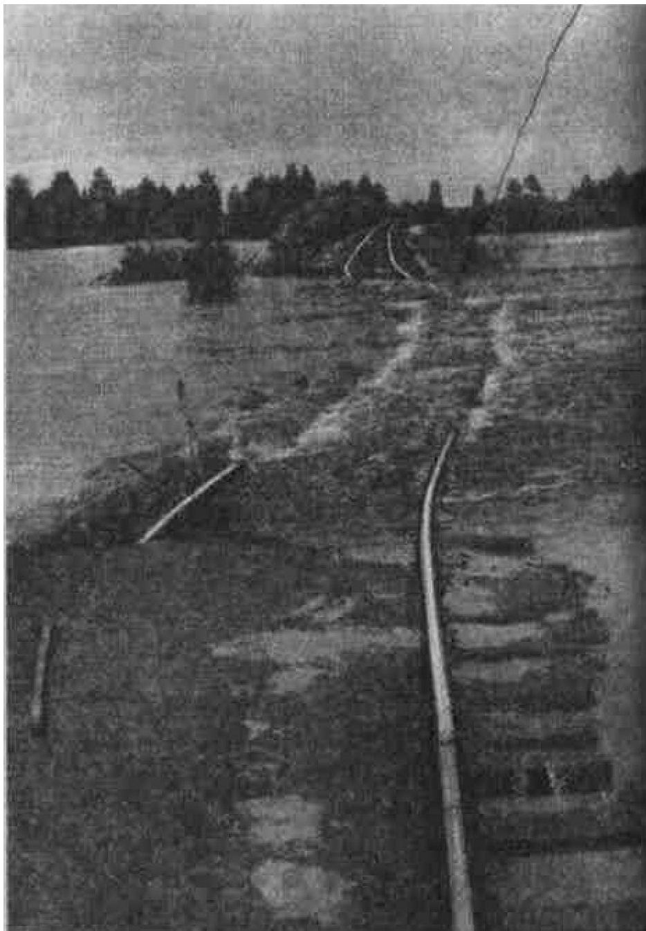
Рис. 72. Повреждения земляного полотна при наводнениях
